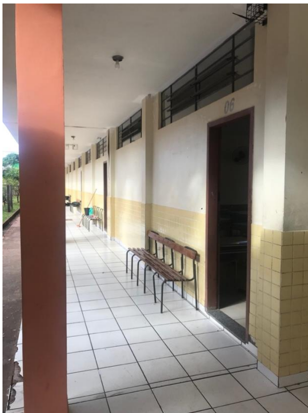
Figura 14: Salas de aula sem rampa.
